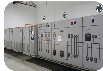
Solar inverters 500kW + 600kW
