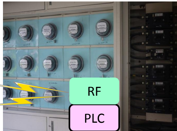
配電盤B PLC訊號較差
