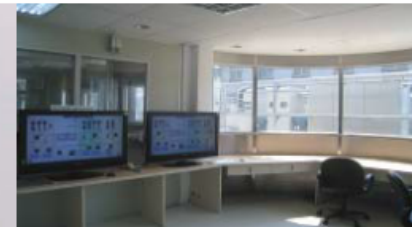
微型電網控制室
