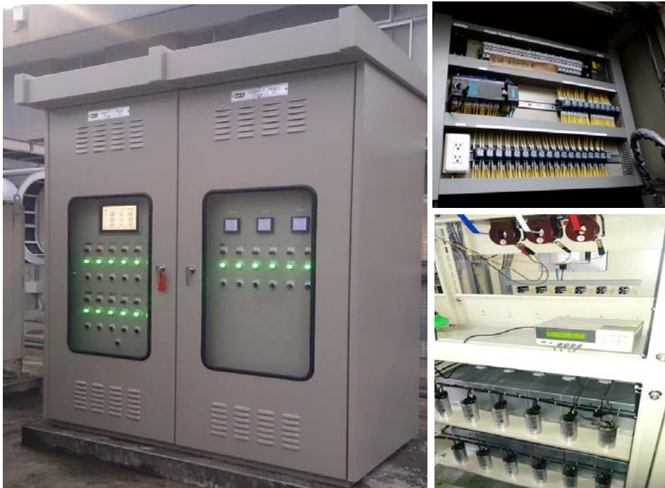
被動式電力濾波器建置
